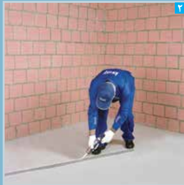
۲ اجرای دو ردیف خمیر درزبند (یا نوار عایق) بر پشت سازه های هادی کف و سقف
