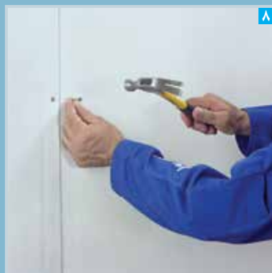
اجرای عوامل اتصال کمکی برای جلوگیری از ناپایداری لایه پوششی در زمان وقوع حریق
