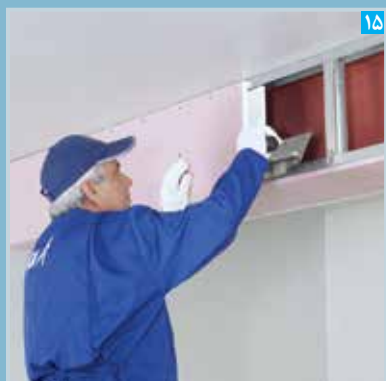
اجرای فوگن فولر بر روی نیمه دیگر پنل پشت بند درز (پس از خشک شدن فوگن فولر نیمه اول)
